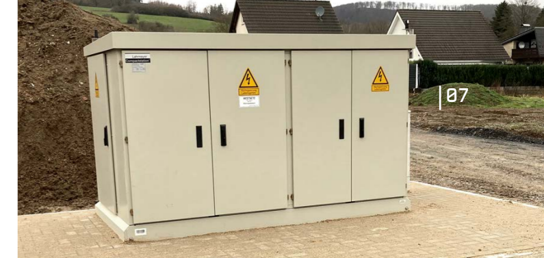
Digitale Ortsnetzstation im Neubaugebiet Hönnewiesen.
